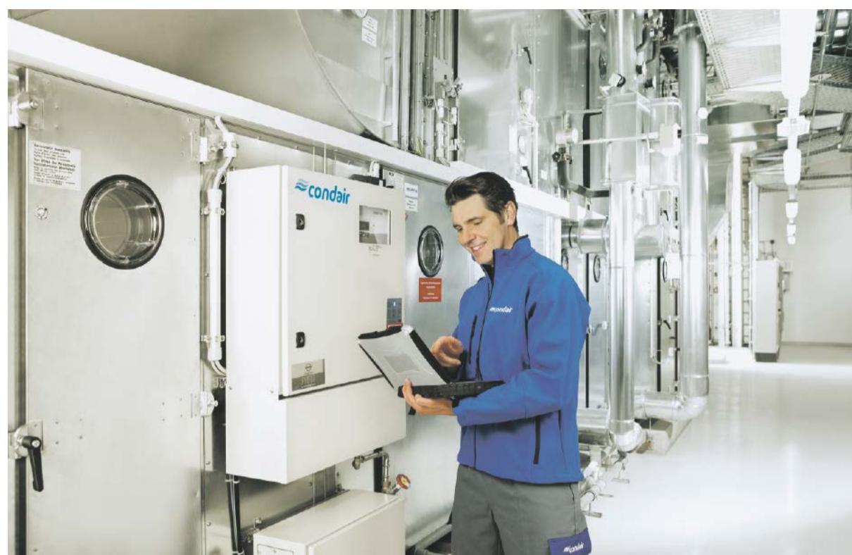
Ein Servicetechniker führt die energetische Inspektion durch und prüft die Hygienequalität an einem Hybrid-Luftbefeuchter.
